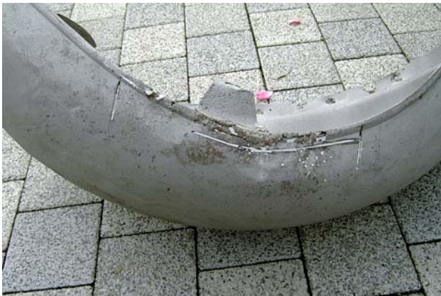
43) Diese Stellen waren nicht mehr zu retten und mussten erneuert werden
