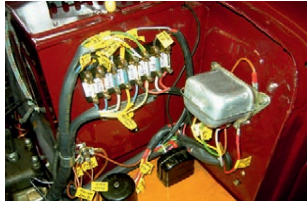
61) Der eingebaute MZ-Regler
